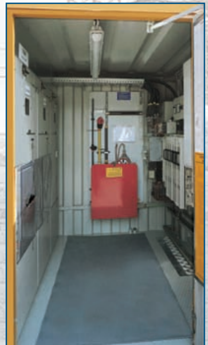
Bedienraum für Mittel- und Niederspannungsschaltanlage
