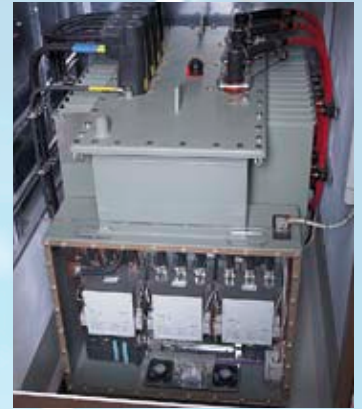
Transformator mit Regeleinheit
