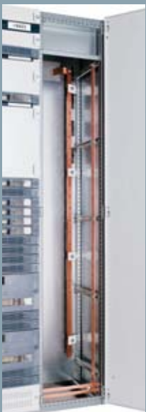
Vertikale Schutz- und Neutralleiterschienen rechts im Kabelanschlussraum angeordnet
