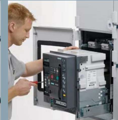
SENTRON 3WL in Wartungsstellung: Inspektion ohne Entnahme des Leistungsschalters
