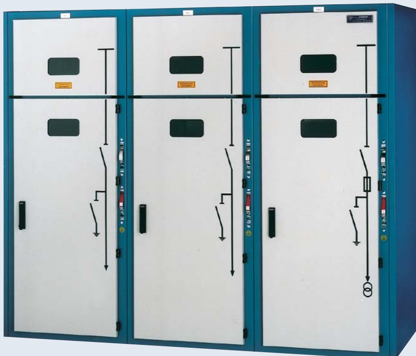
Lasttrenner- Schaltanlage 12 kV
